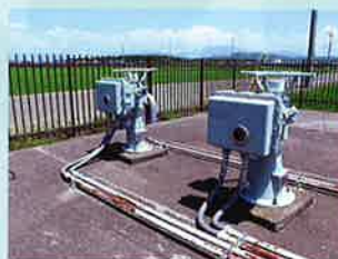
分水工バルブ (14箇所)
