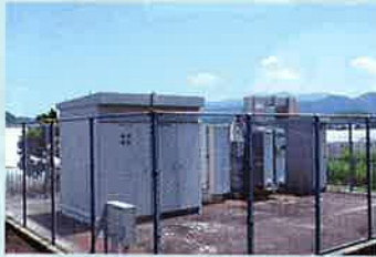
特高受変電設備
