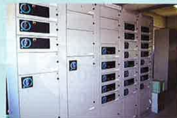
コントロールセンター
