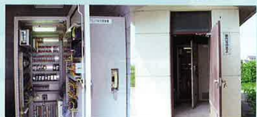
天の川揚水機場から分土工等 (計15箇所) との 遠方監視制御装置及び機側計装盤
