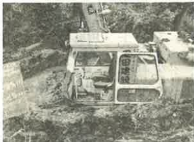
沼周辺の軟弱地盤で沈んだ重機
