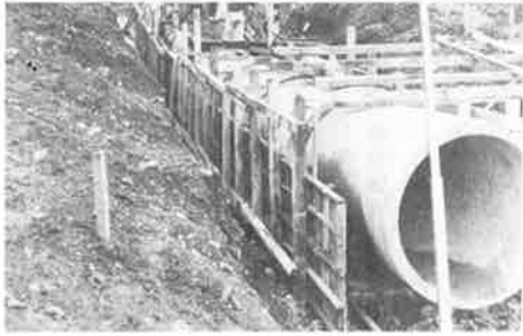
左岸取入れのため右岸側へ送水用の パイプを堰体の下部に埋設 (S31.1)
