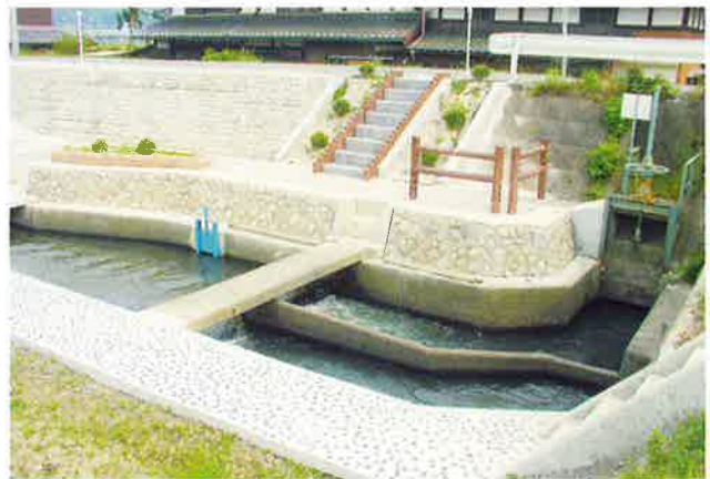
■上多良親水性分水工
