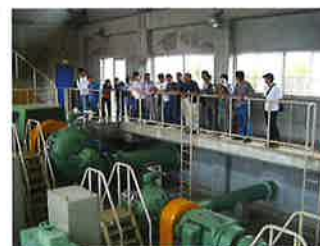
施設見学会(天の川揚水機場)
