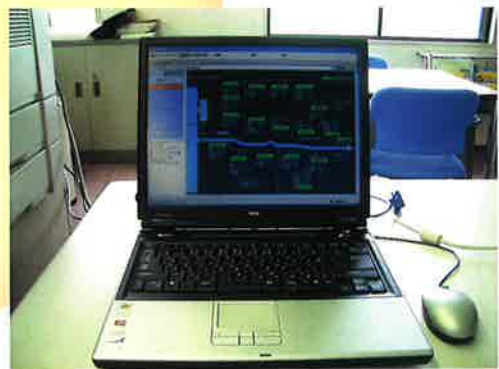
事務所より運転状況等を監視
