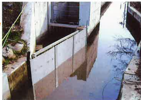
土川サイホンにごみ流れないように仕切板で水路の底水を取水しています。
