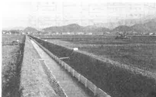
天の川西部 朝妻筑摩第二工区工事 27号支道から10号支排以南を望む
