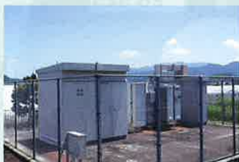
特高受変電設備
