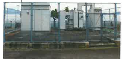
特別高圧受変電設備
