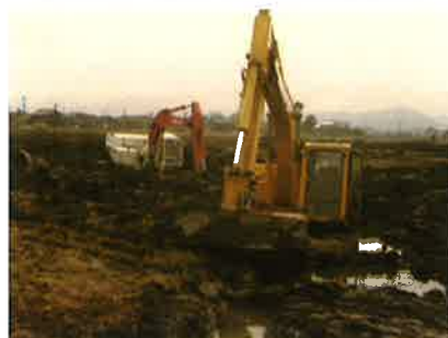
難工事! 軟弱地盤で重機沈む
