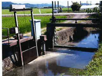
② 循環かんがい施設 宇賀野排水路ゲート
