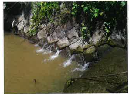
③ 夏目井堰：漏水箇所
